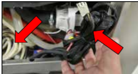
Tuyau de détartrage enroulé et câble noir enroulé.
